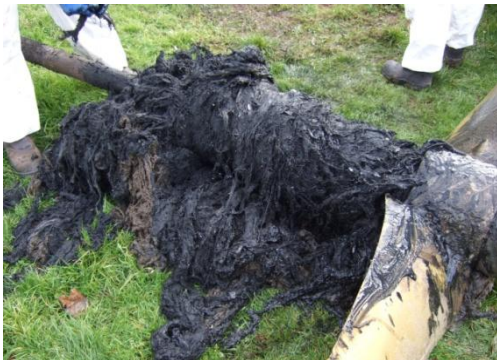
Agitateur de station d'épuration encombré par les lingettes.
